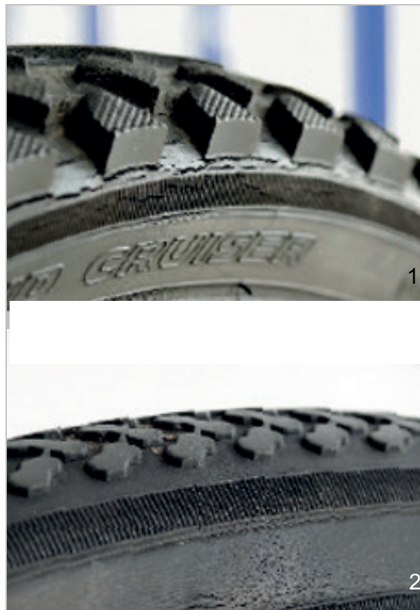
153. ábra: Példák kifáradási repedésekre (1) és öregedési repedésekre (2)
